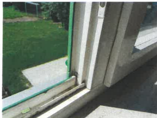
Verglasung Klassenzimmer EG
