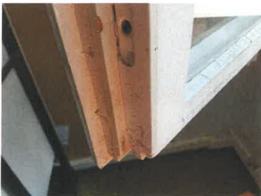
Verglasung Klassenzimmer EG
