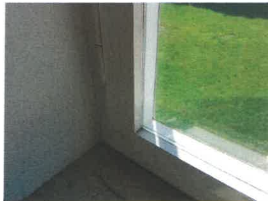
Verglasung Klassenzimmer EG
